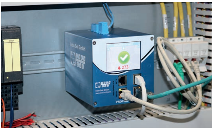
Bild 1: Dezentrale Datensammler wie hier der PROFINET-INSPEKTOR® NT analysieren das Netzwerk dauerhaft passiv und ermitteln den jeweiligen Zustand. Auf dem Display können zudem erste Diagnoseinformationen der aufgelaufenen Alarmer eingesehen werden.
