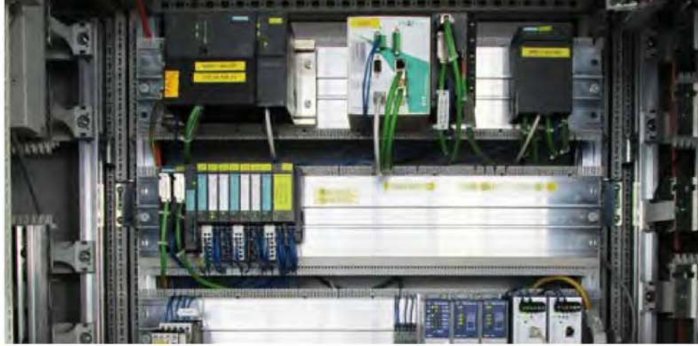
Der PROFINET-INSpektor® im Schaltschrank der Batteriekommissionierung. Er wird zur dauerhaften Überwachung genutzt und gibt Meldungen, bevor es zu einem Ausfall kommen kann.
